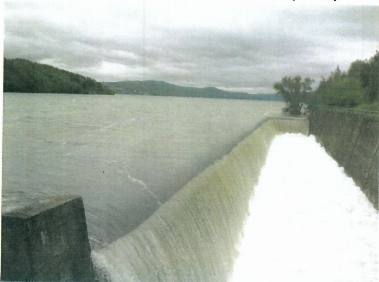
Obr. 3.3 – aktívny BP nádrže Veľká Domaša 17.V.2010 pri vodnom stave 162,68 m Bpv a prietoku zhruba 90 \text{ m}^3/\text{s} (foto SVP)
